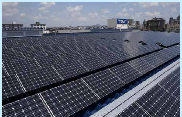
太陽光発電実証設備と後方はLED看板
