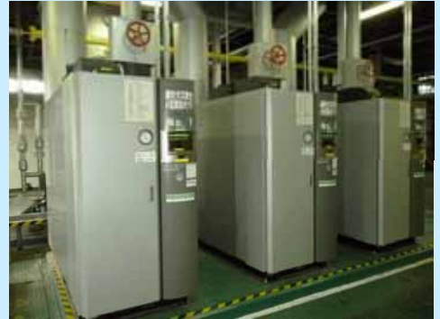
貫流ボイラ外観
